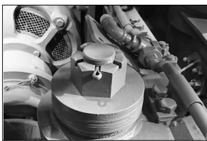
写真9 緩み止め(溝付き六角ナット+割りピン)
