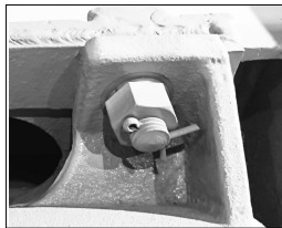
写真7 脱落防止(割りピン)
